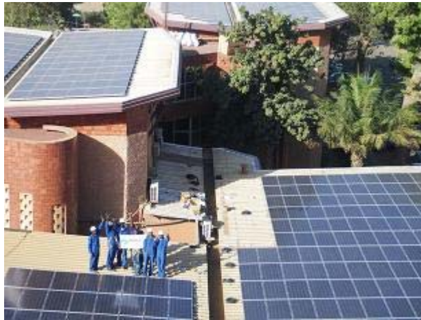
Solar powered generator - Société Générale de Banques au Burkina (SGBB)
