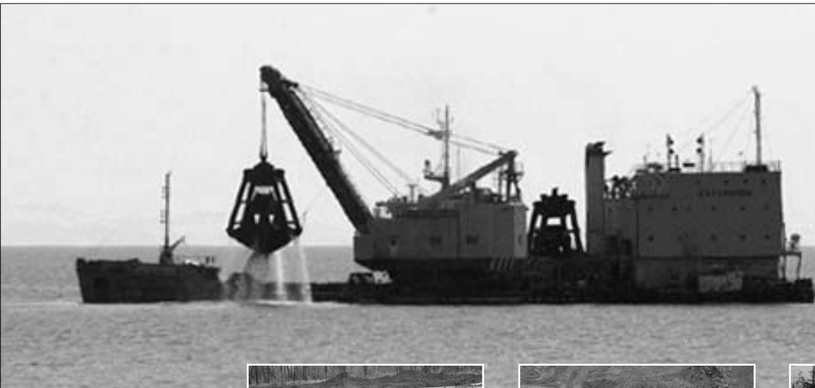
18 Verklappung von Bauabfällen in der Anivabucht senkt die Fangquoten der Fischer Quelle: Sakhalin Environmental Watch
